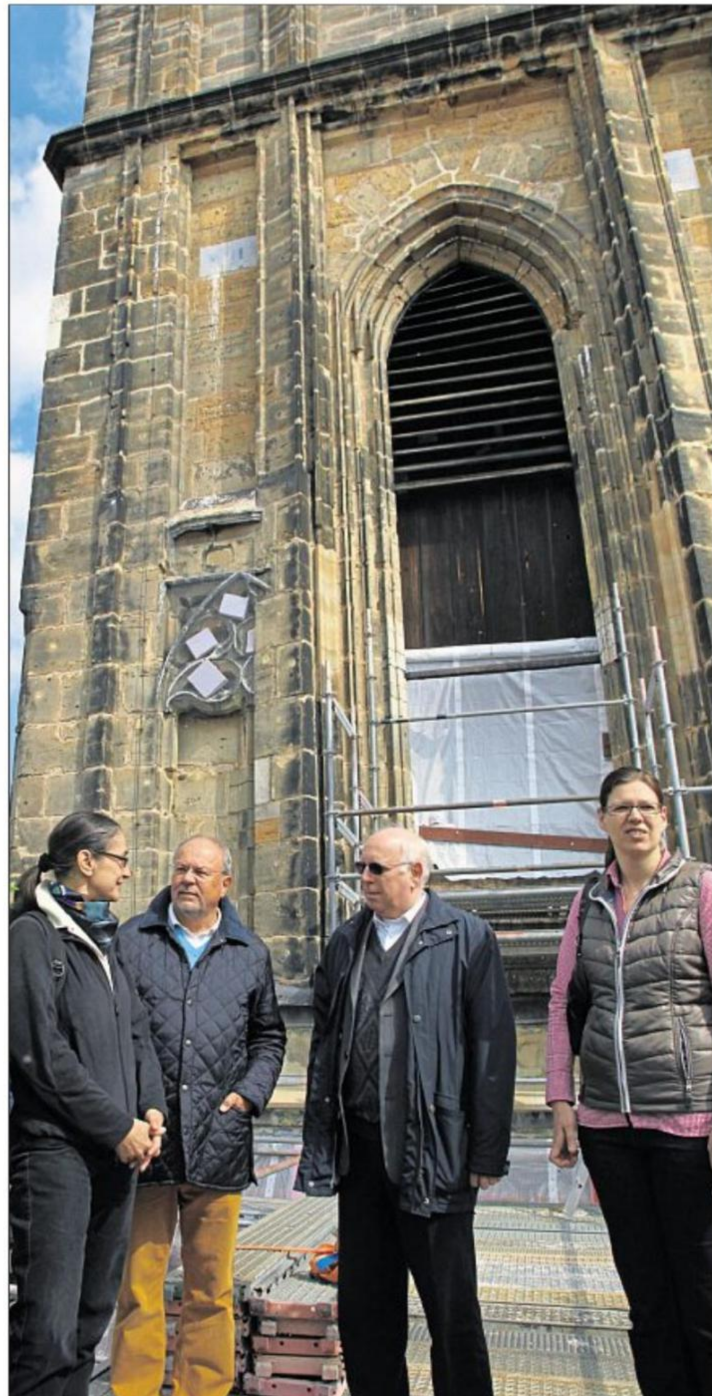
Baustellen-Besichtigung in luftigen 35 Metern Höhe – da kann man auch im Juni noch eine Jacke tragen. Architektin Carola Setz, Kirchenpfleger Josef Beer, Pfarrer Franz Meiler und Tragwerkplanerin Katrin Schmidl (von links) besprechen den Stand der Martinsturm-Sanierung. Bild: wsb
